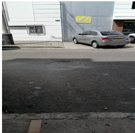
Imagen 2. En la calzada se observa daño del pavimento flexible por acometida en mal estado .
