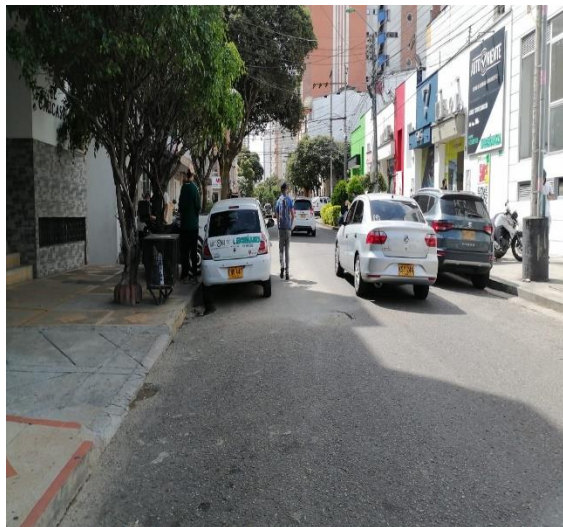
Imagen 1: Carrera 23 con calle 55 se observa pavimento flexible en condiciones regulares
