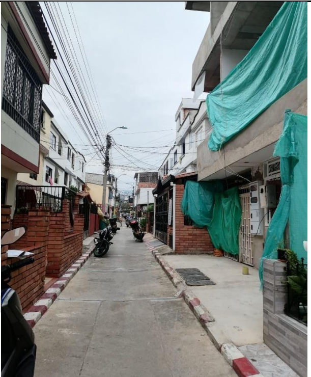
Imagen 2: Rotura en franja de circulación Barrio: Los Heroes
