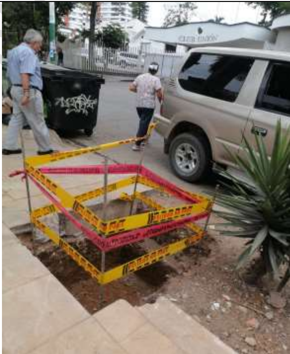
Imagen 6: Se observa rotura para caja de inspección sobre la calle 32.
