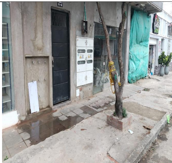
Imagen 4: frente del predio donde se instala los contadores de gas cra 22
