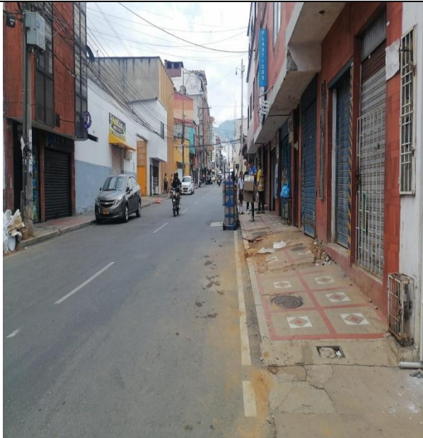
Imagen 2: Rotura en la calzada de la calle 34 Barrio: Centro
