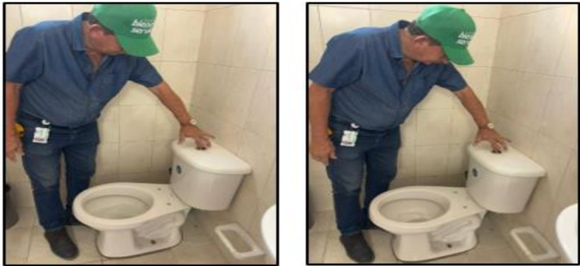
Imagen Arreglo botón desagüe
