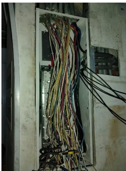
IMAGEN No 3 : TABLERO GENRAL ANTES
