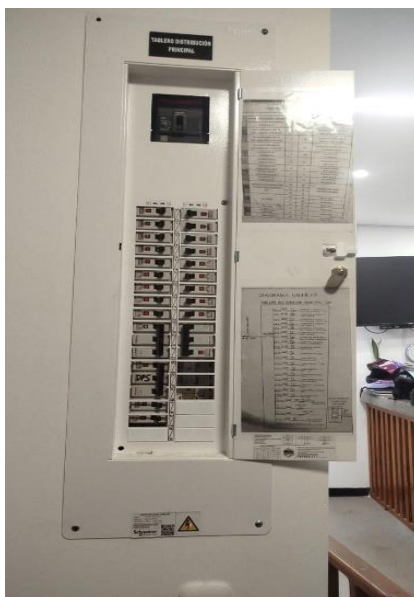
IMAGEN No 4. TABLERO GENERAL DESPUES
