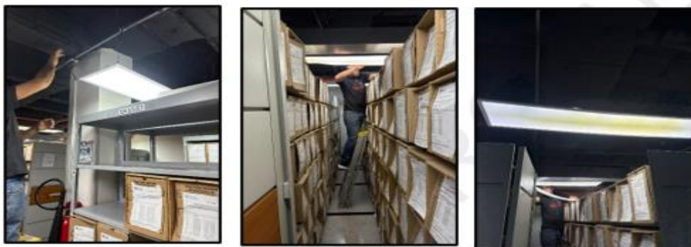
Imagen: Cambio iluminaria
