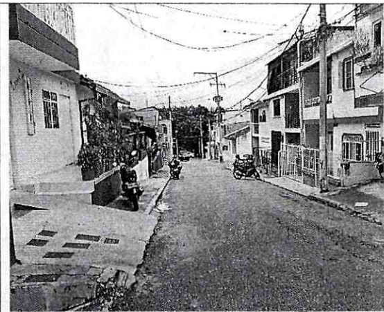
Imagen 10: calzada en condiciones regulares.
