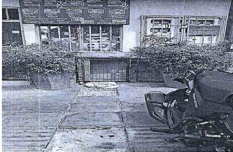
Imagen 3: caja de contadores de gas- calle 16
