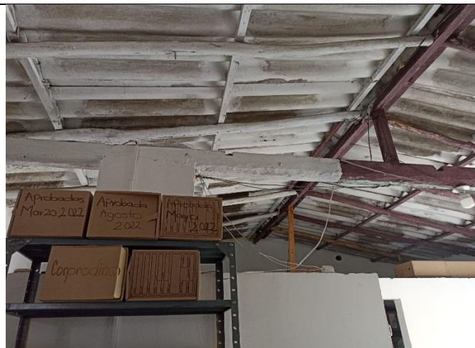
Fotografía 17. Tejado en mal estado
