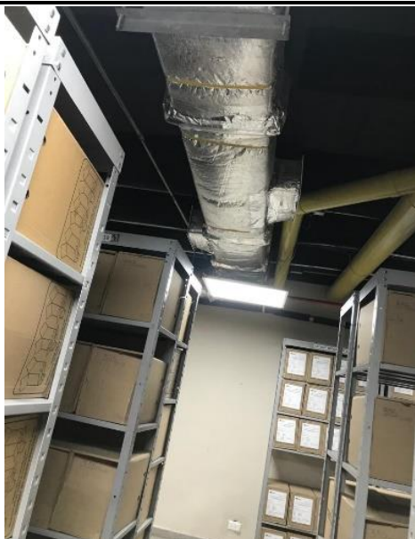
Fotografía 47. Ducto aire acondicionado
