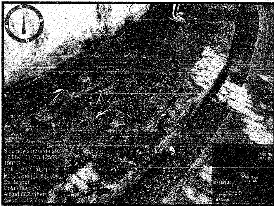
Figura No.02. Toma del estado actual tramo de anden - Barrio Manuela Beltran Bucaramanga.
