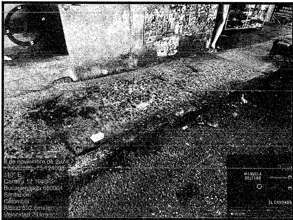
Figura No.03. Toma del estado actual tramo de anden - Barrio Manuela Beltran Bucaramanga.
