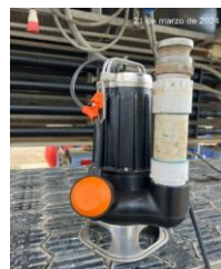
Entra en operación nueva bomba para extracción de lodos Lodos #2
