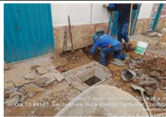
Instalaciones cometida de acueductos
