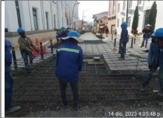
Amarre y figurado de acero parrillas de refuerzo lozas sobre calzada vehicular
