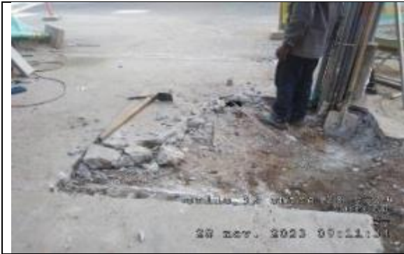
CALLE 32 ENTRE 28 Y 29 COST SUR
