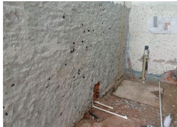
Demolición de enchapes de piso y muros para la adecuación de puntos hidrosanitarios de Baños CAIV
