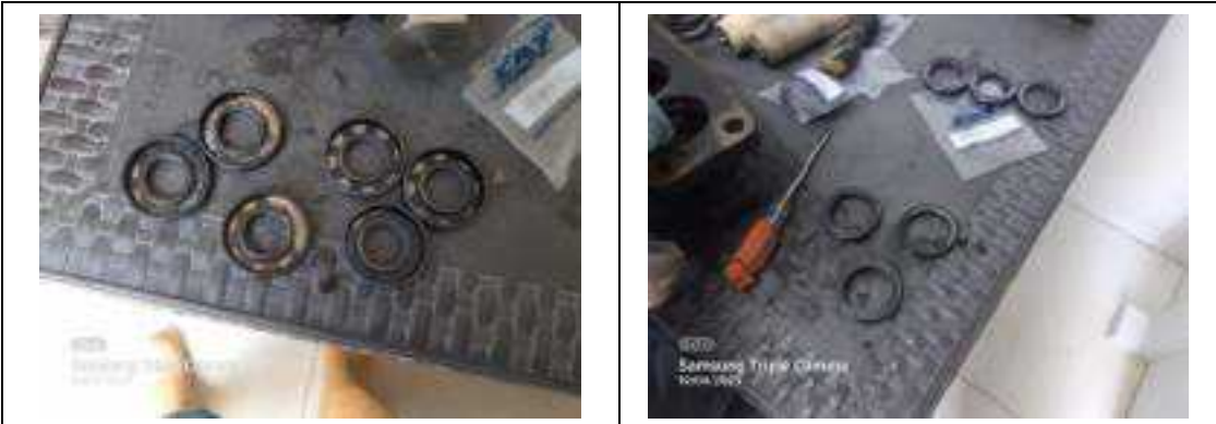
Reemplazo de las electroválvulas No.17011,19411, 09711 de la DTRO (Mayo/23)
