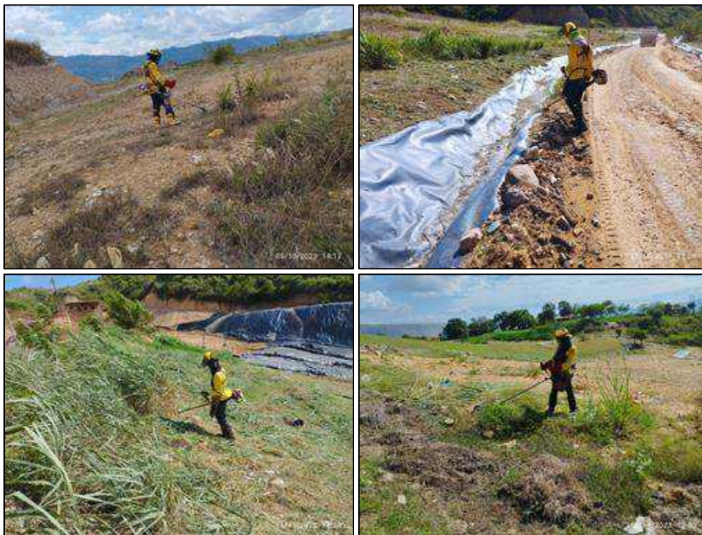
Ilustración 11 Actividades de cierre y clausura celda de contingencia, celda 2, celda de respaldo 1 y celda de respaldo 2
