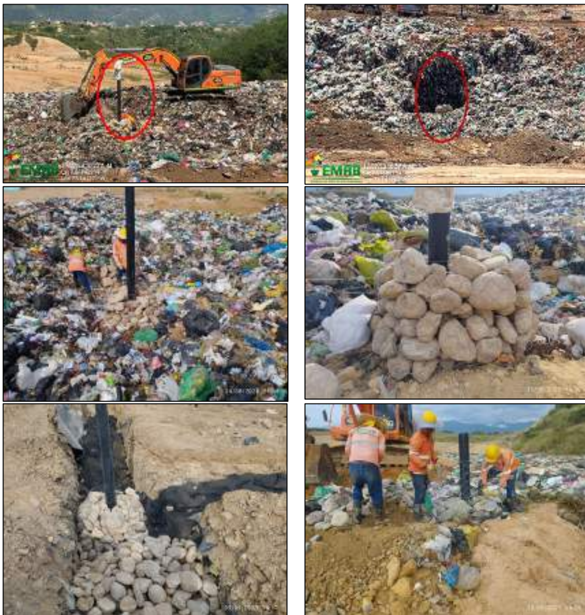
Ilustración 24 Realce de chimeneas celda actual de disposición.
