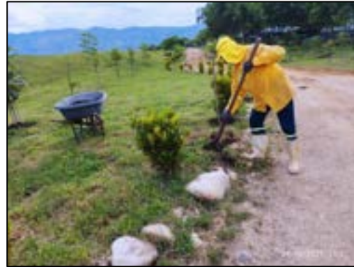
Ilustración 16 Siembra de árboles y arbustos en la divisoria del parque contemplativo y celda 4
