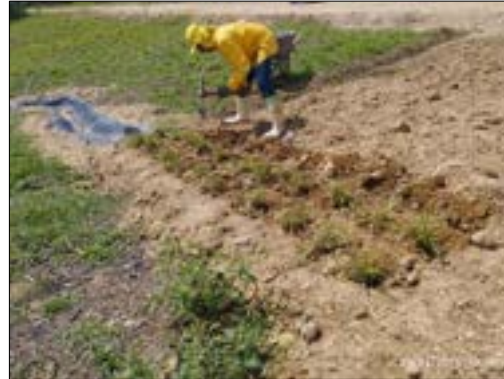
Ilustración 10 Establecimiento de la capa de orgánica en 2700 m2 de geocelda en la celda 4
