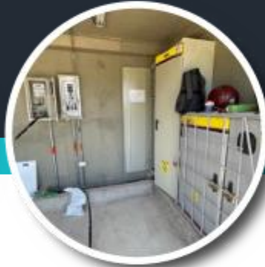
Fotografía 3. Interior subestación eléctrica
