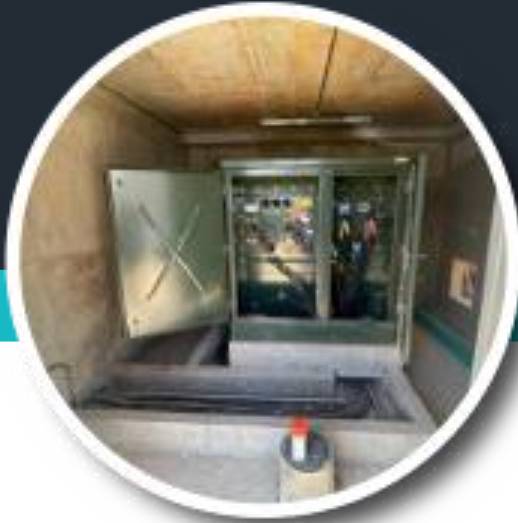
Fotografía 2. Interior subestación eléctrica.
