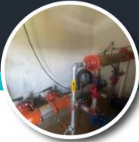
Fotografía 4. Interior equipo de bombeo tanque de almacenamiento de agua
