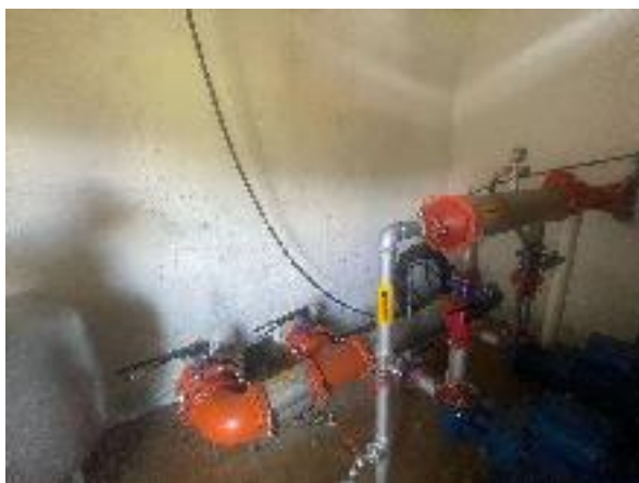
Fotografía 4. Interior equipo de bombeo tanque de almacenamiento de agua
