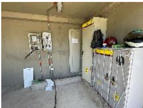
Fotografía 3. Interior subestación eléctrica
