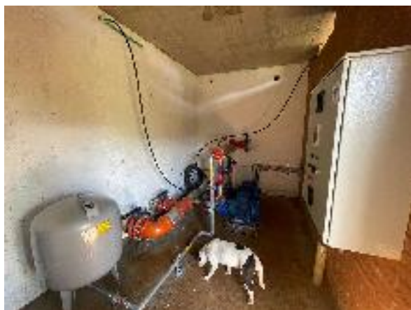
Fotografía 5. Cuarto de bombas tanque de almacenamiento de agua
