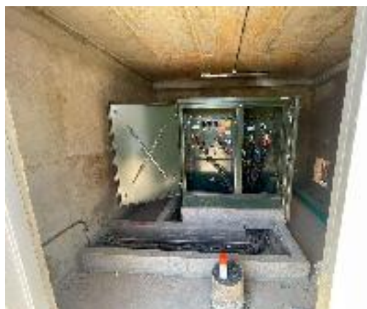
Fotografía 2. Interior subestación eléctrica
