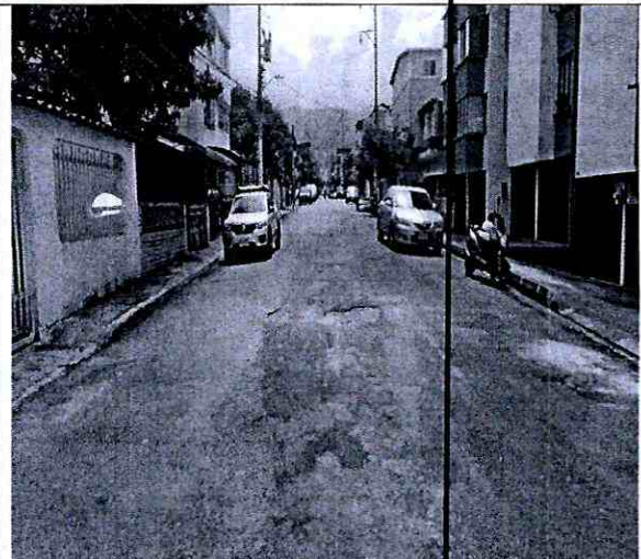
Imagen 2: Calle 51 entre carreras 13 Y 13A Barrio: Candiles
