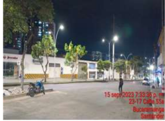
Funcionamiento Luminarias instaladas
