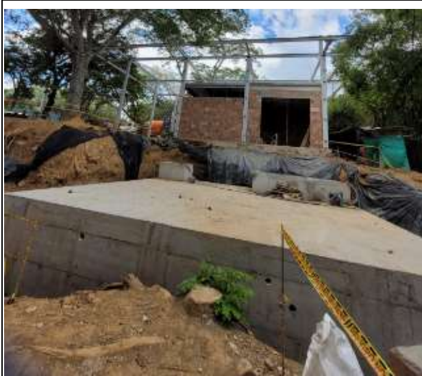
Tanque de almacenamiento
