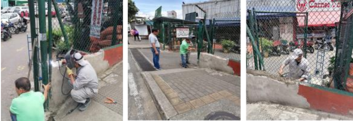
SAN FRANCISCO: sondeo de cañerías, cambio de mallas, reemplazo de luminarias especiales y cambio de cubiertas.
