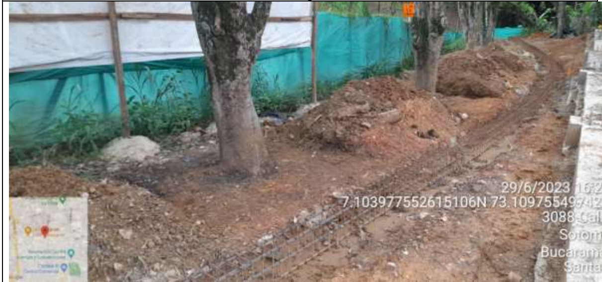
Acero estructural, viga de cerramiento
