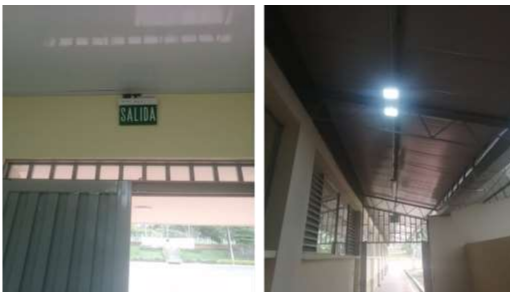
Sistema de iluminación de emergencia
