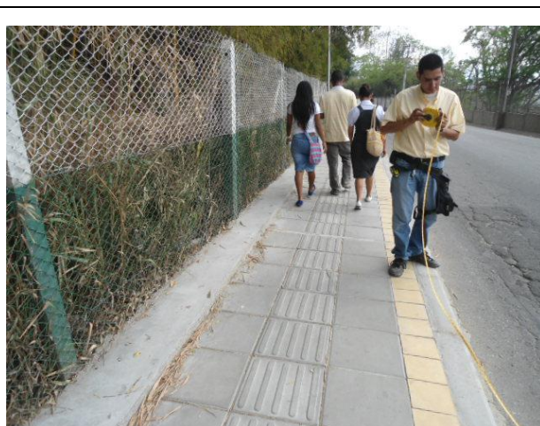
Ahora – Andenes Vía a Morrорico
