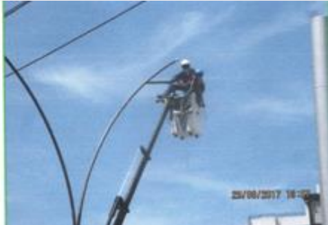
lizada de postes para alumbrado en el separador de la autopista.
