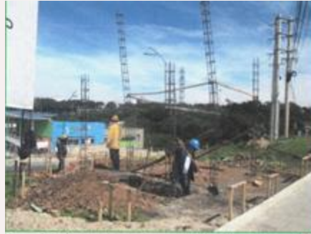
Acero de refuerzo para columnas de la subestacion electrica. Acero longitudinal de diametro 1/2" y flejes de diametro 3/8".
