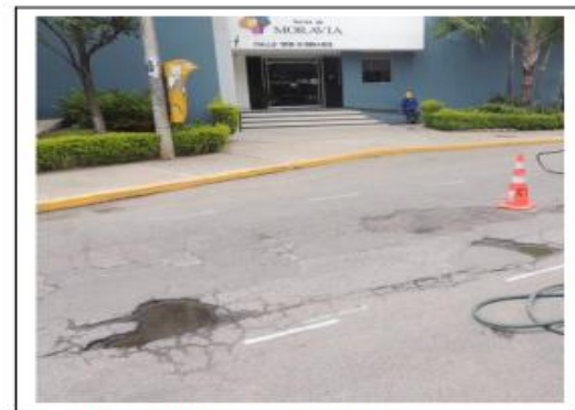
FOTO ANTES DE LA INTERVENCION
