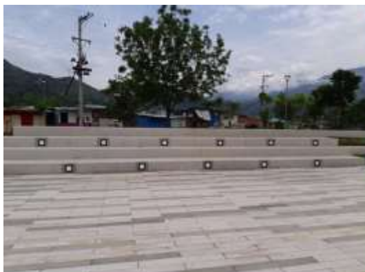
LUMINARIAS EN GRADAS DE PLAZOLETA CENTRAL DEL PARQUE LINEAL RIO DE ORO
