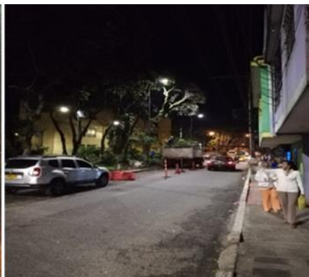
CIUDAD BOLIVAR – ILUMINACION COMPARTES ESPACIO CON LOS ARBOLES DE LA ZONA, SE REALIZÓ PODA PARA DAR MÁXIMO USO A LAS LUMINARIAS INSTALADAS.
