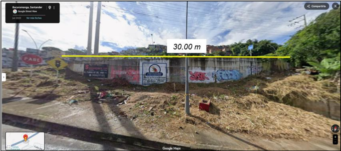
Fotografía 05: Muro, Calle 70 Colinda Con El Parque Lineal, Quebrada La Iglesia. Link GoogleMaps/ https://maps.app.goo.gl/7y9jfDouF4RxMvo39
